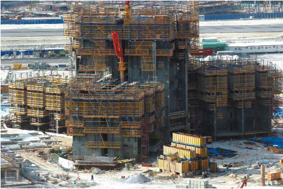
Die ersten sieben Stockwerke des Burj Dubai im Rohbau. Jede Woche kommt ein Stockwerk hinzu.
